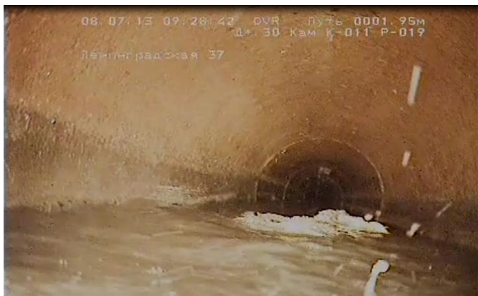
Рисунок 17 – Пример результата телеметрического обследования канализационного трубопровода
